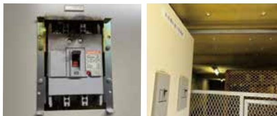
配電盤が燃焼した例
